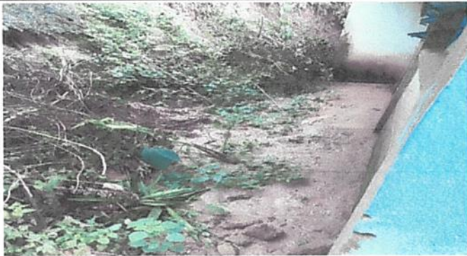
FOTO 1: Deslave a causas de lluvias
