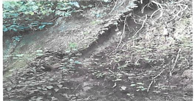
FOTO 2: Desprendimiento de tierra
